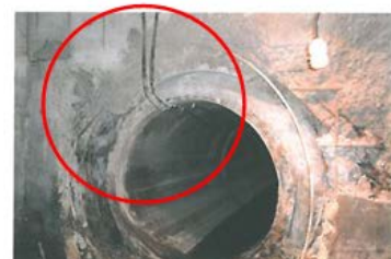
人孔躯体破損箇所为例
