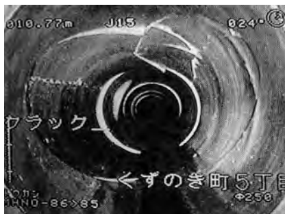
被災した污水管渠
