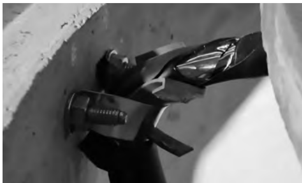
写真3 人孔部での外皮損傷（サドル部）
