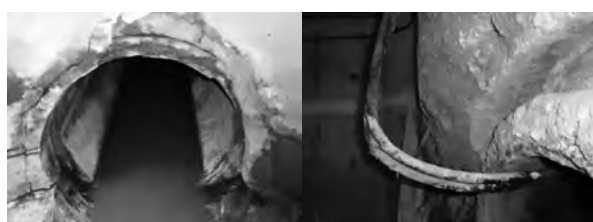
写真1 地震による管口、光ケーブルの被害
