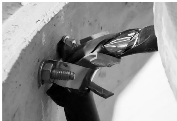
写真2 人孔部での外皮損傷（サドル部）
