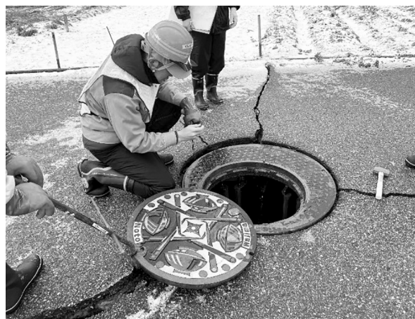
能登半島地震における被害調査
