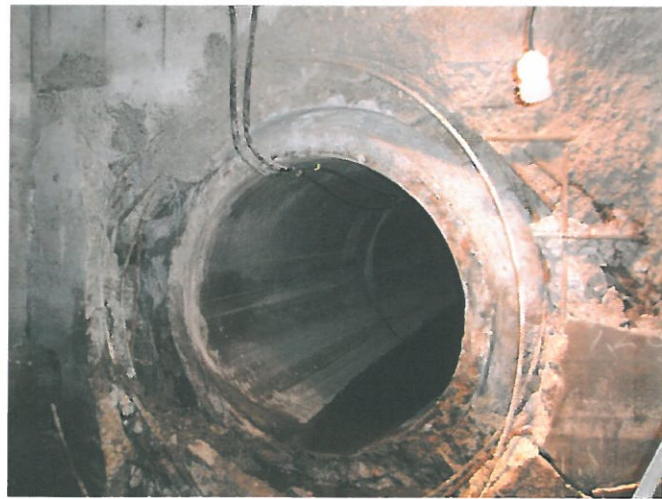
人孔接続部の破壊でも機能正常
