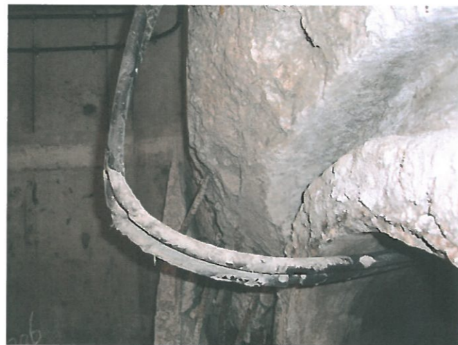
人孔接続部の破損でも機能正常
